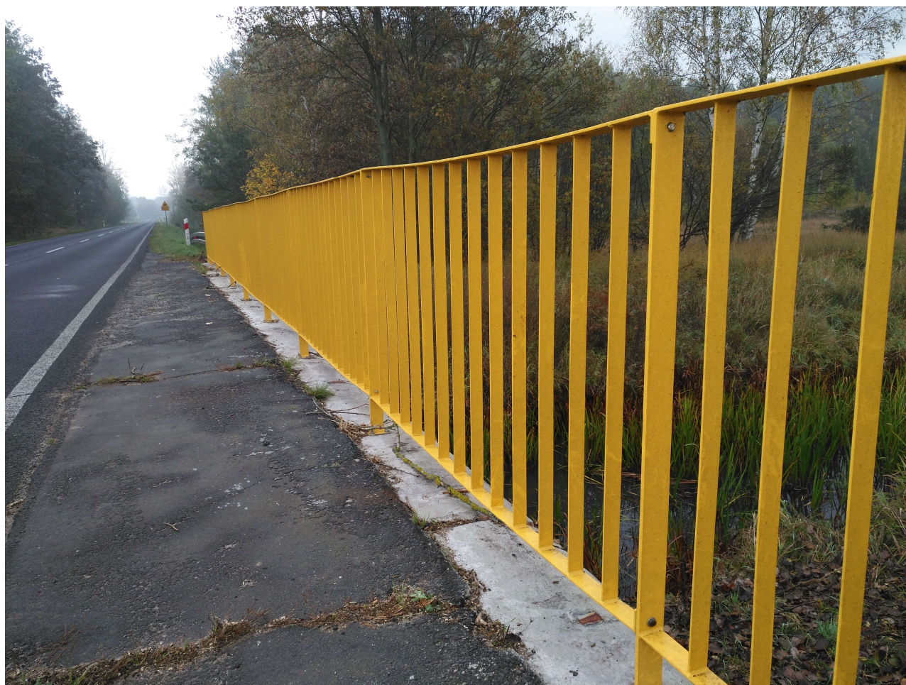
Zdjęcie nr 5 – balustrada mostowa U-11a
