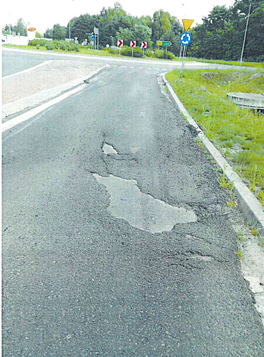
Rys. 7. Widok uszkodzeń warstwy ścieralnej dojazdu do ronda (2023.08.23, fot. ZDW ZG)
