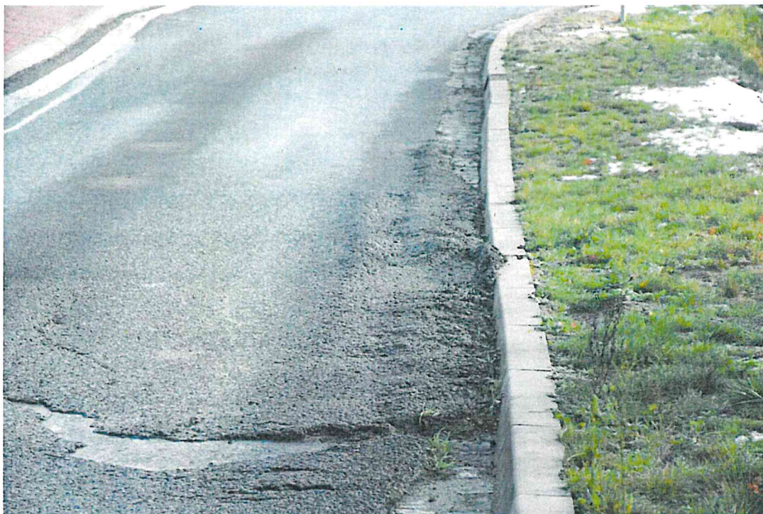
Rys. 5. Widok uszkodzeń warstwy ścieralnej dojazdu do ronda (2022.11.23, fot. Autor)
