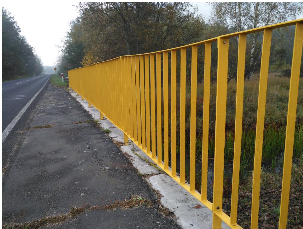
Zdjęcie nr 5 – balustrada mostowa U-11a
